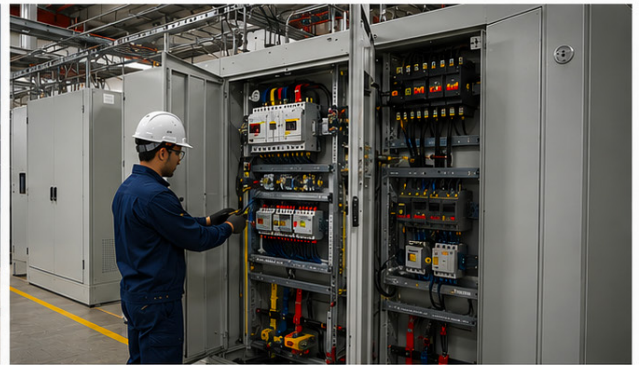
أنظمة توزيع كهربائي مخصصة
