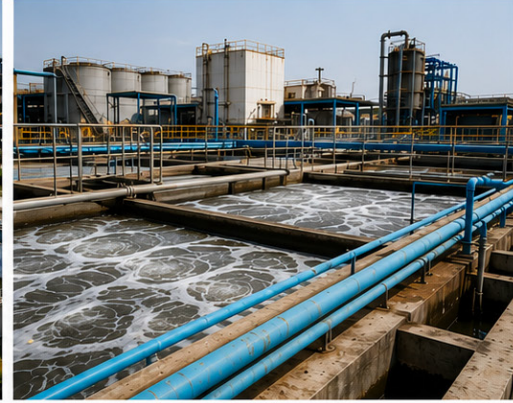
محطات معالجة المياه المعالجة (الصرف الصناعي)
