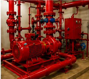
مضخات مكافحة الحريق
