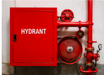
شبكات صناديق الحريق (الهيدرننت)
